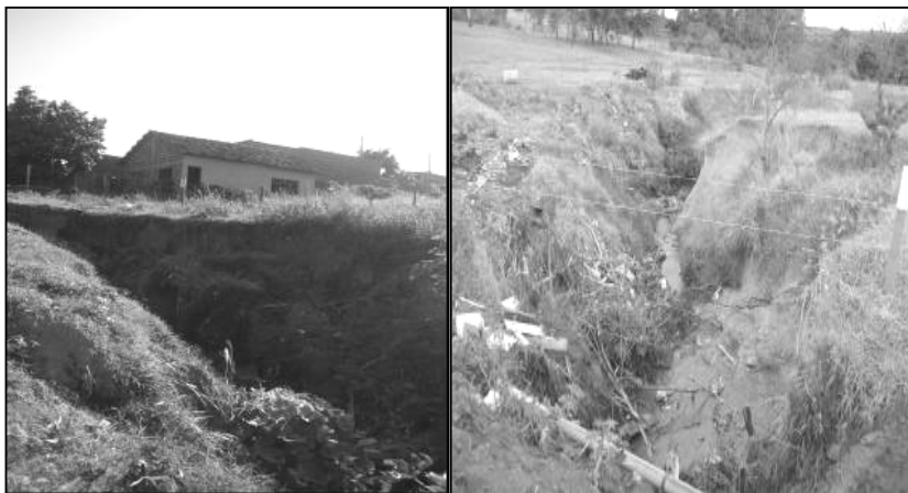
Foto 1 – Voçoroca na área verde nº5, bairro Jardim Santa Tereza. (Dez/2005) Foto 2 – Área verde não efetivada nº5, atrás da praça Sebastião Zanetti, bairro Jardim Santa Tereza. (Jun/2005)
